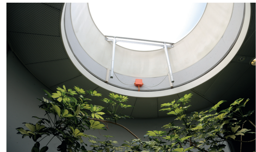
On profite du système KNX mis en place pour la gestion des stores pour assurer le refroidissement naturel du bâtiment pendant la nuit
